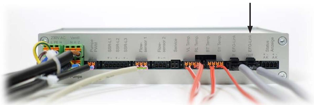
Abb. 38: EFG-Link-Kabel des EM24-DIN in der Out-Buchse des Stan 2.0
