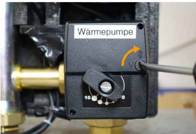
Abb. 48: Mischventil auf Handbetrieb stellen
